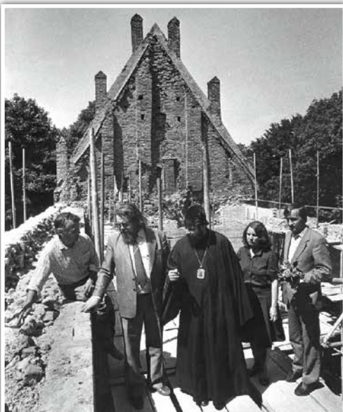
Архиепископ Смоленский и Вяземский Кирилл наблюдает за восстановительными работами на месте будущего Свято-Никольского храма
