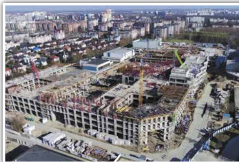
Строительство кампуса БФУ им. И. Канта на улице Александра Невского в Калининграде
